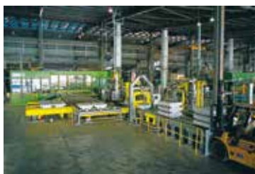
Горизонтальные установки непрерывной разливки
